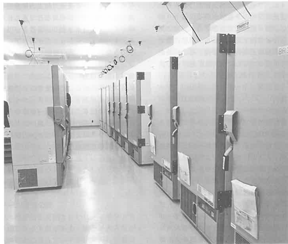
図1：現在2017年の超低温冷凍槽室
